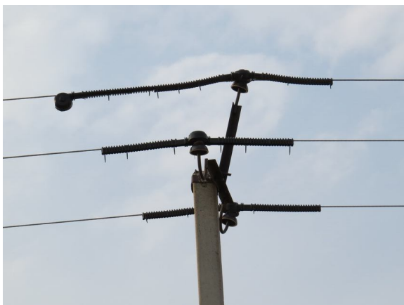
Рис. 1-5. Примеры поломки и утери ПЗУ на ЛЭП
