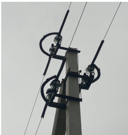
Рис. 9. Исправленные недостатки на ЛЭП компании "Мегафон".
